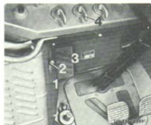
Fig. 25 Dispositif de chauffage et d'aération 404.1
